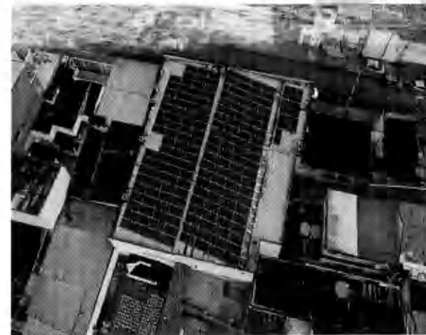
Galpões Mansão Royal 98 kWp
